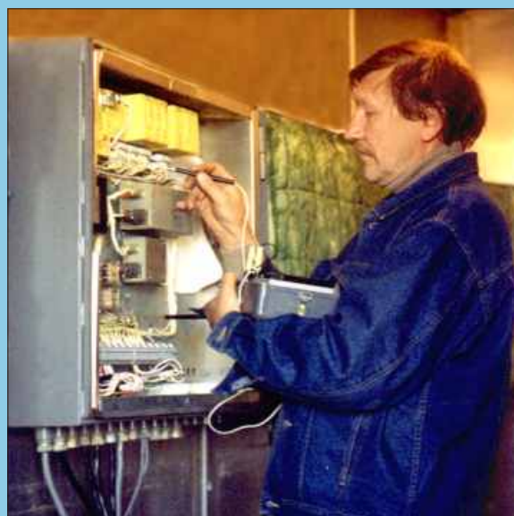
Щкаф контроллера. Наладка на объекте.
